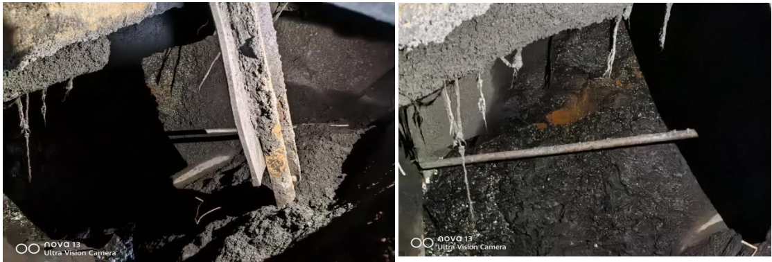
204 带式输送机机头卸煤漏斗内掉落清煤器、钢管（图 1-11）
