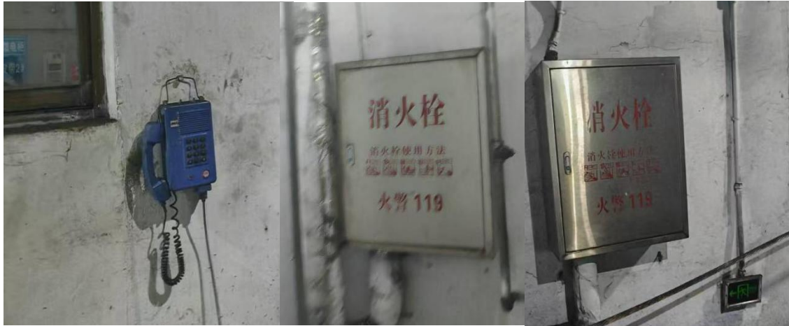
洗选车间电话、消火栓、安全出口标志（图 1-2）
