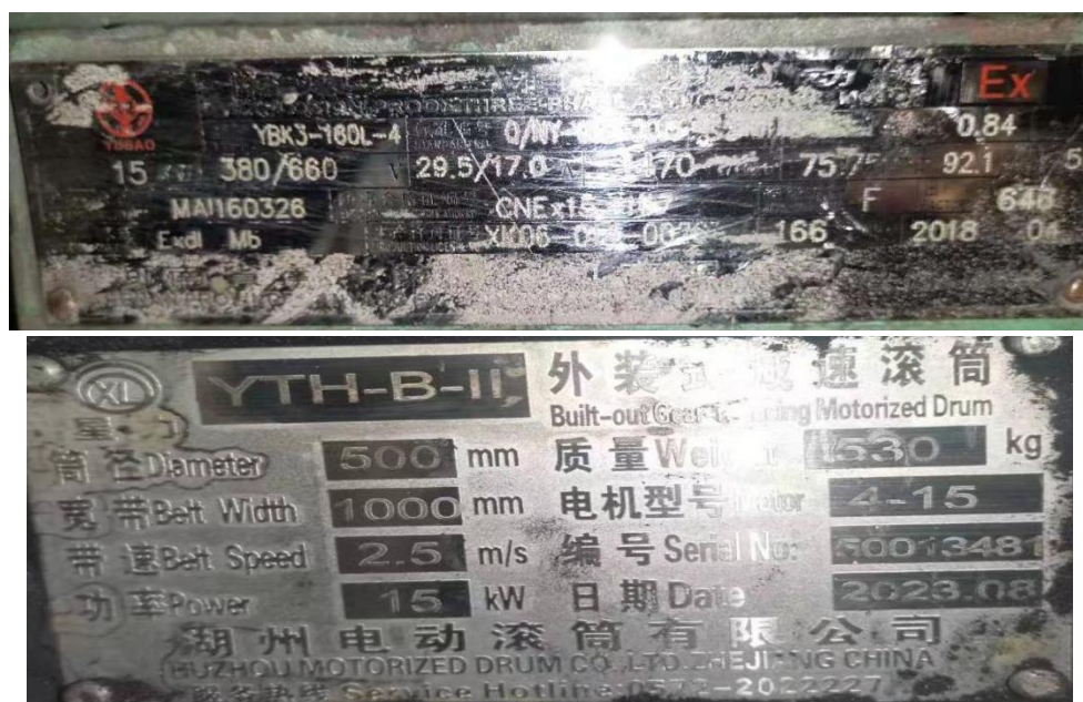
204 带式输送机电机、滚筒铭牌（图 1-4）
